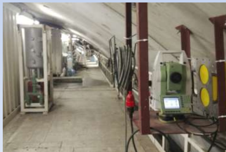
Instrument odpowiedzialny za sterowanie maszyną TBM
